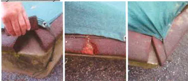
1) Sedáky jsou poškozené, roztržené, chybějící části
